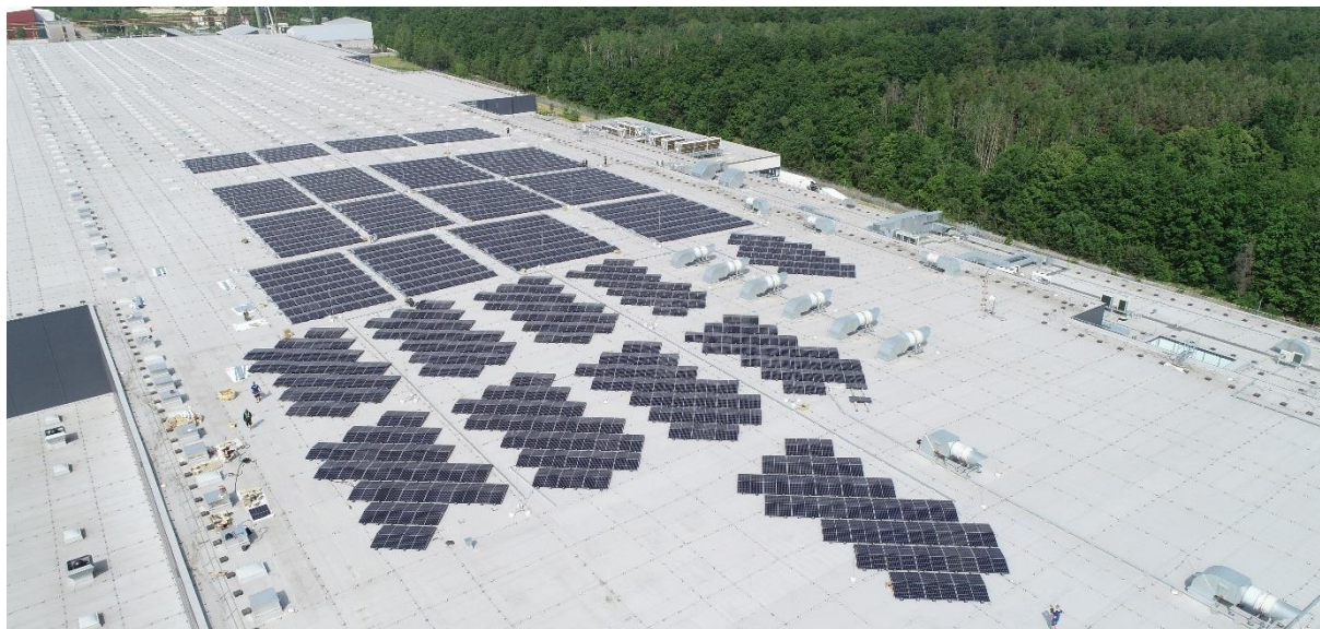
Obrázek 1 – Fotovoltaická elektrárna na ploché střeše (Logistické centrum LIDL Buštěhrad)
