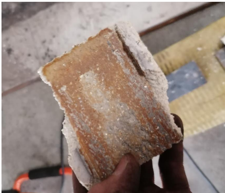
Obr.6: Odpadlá ochranná vrstva po požárním experimentu
